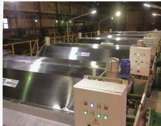
Filtrace dešťové vody FOSAGRO, Čerepovec, Rusko, 16FD_O
