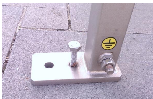
Obr. 25 Hlavní zemnicí bod
