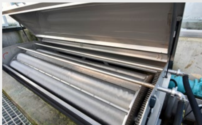
ČOV Uherské Hradiště, Česká republika
